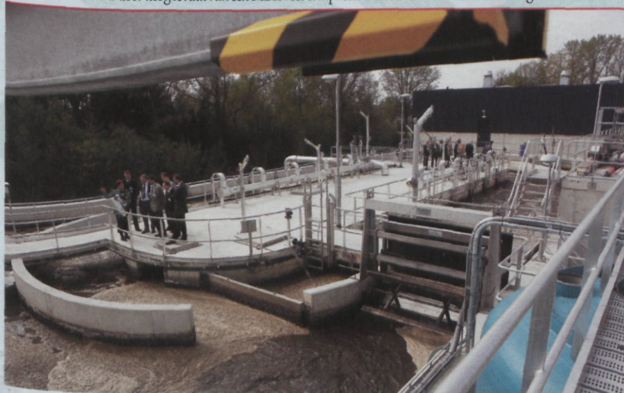
De rwzi Varsseveld is door het gebruik van een MBR veel compacter dan een conventionele zuivering.
