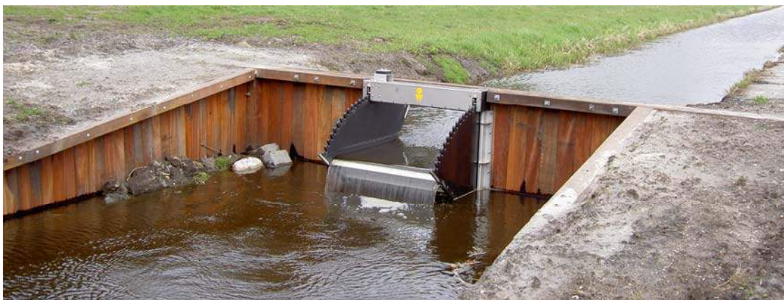
Figuur 6: Kunstwerk K2, uitlaat piekberging: kantelstuw in een houten damwand, (op de afb. zonder Greenboxen auma). Deze auma kan rechtstreeks op de bovenbrug, maar hij kan ook met een kolom verhoogd worden zodat je al staand bij de box kan komen.
