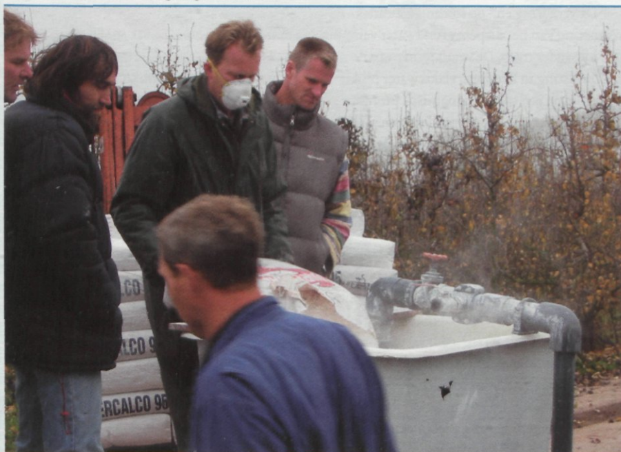
Toedienen van de kalk in de beregeningsinstallatie.
