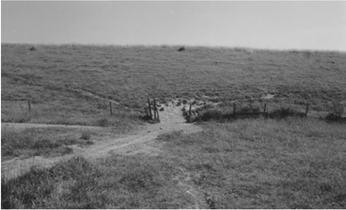
Inloopschade door het tegelijkertijd weiden zeedijk en een aangrenzend perceel
