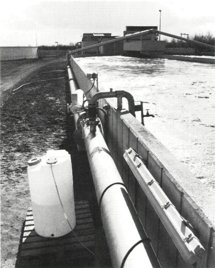
Afb. 6 - Mierezuurinjectie in het luchtleidingnet.
