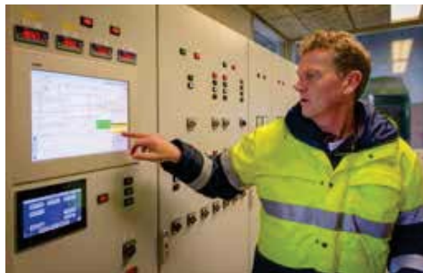
Siebold in de operatiekamer van het H.G. Miedemagemaal
