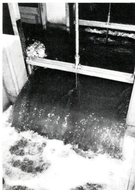
Afb. 11 - Menging ijzerdosering vóór het vlokvormingsstadium.
