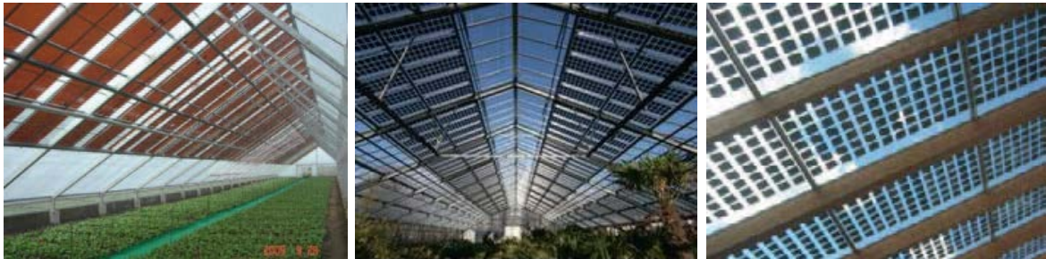
Foto 16, Foto 17 en Foto 18: PV panelen in het kasdek (bron: Hermans Techniek Nederland bv, Kaatsheuvel)
