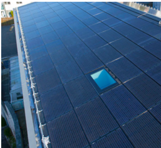
Foto 13: Zonnepanelen als dakplaat
