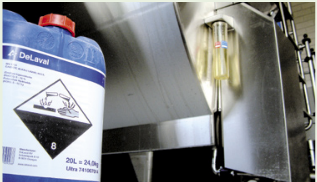
Een melktank, maar ook de rest van de melkinstallatie, is goed te reinigen zonder gebruik te maken van een chloorhoudend middel. Dat voorkomt chloroformvorming in de installatie.
