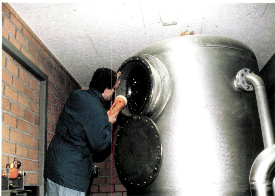
Afb. 9 - Vacuümontgasser praktijkinstallatie Montferland.
