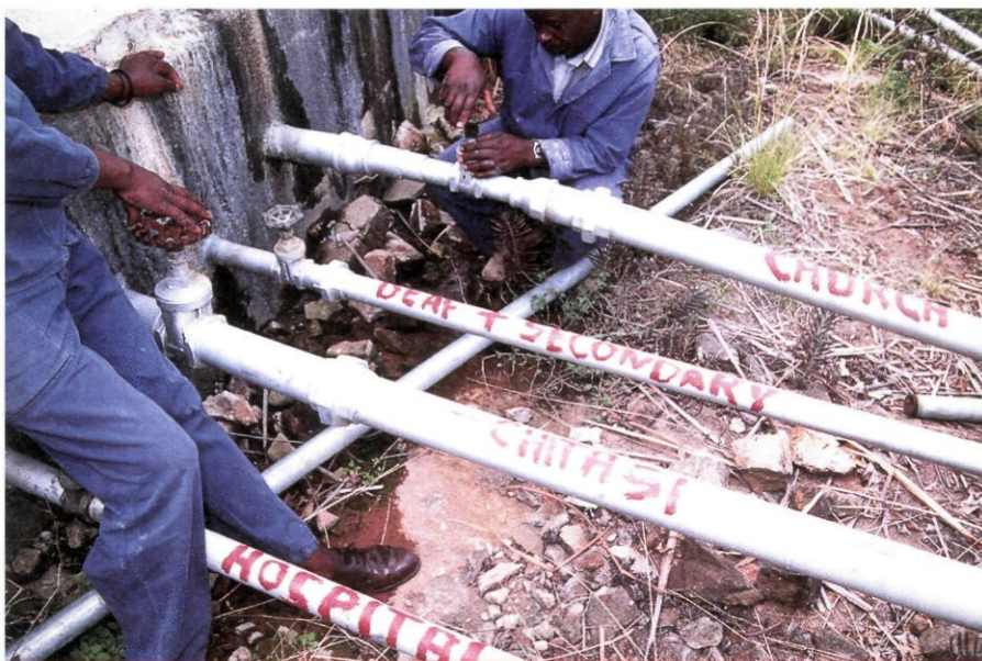
Bijna alle waterleidingen liggen nog boven de grond.
