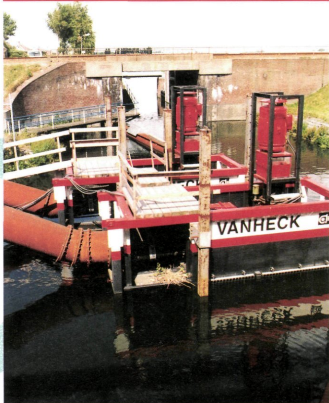
De noodvoorziening bij gemaal Westland
