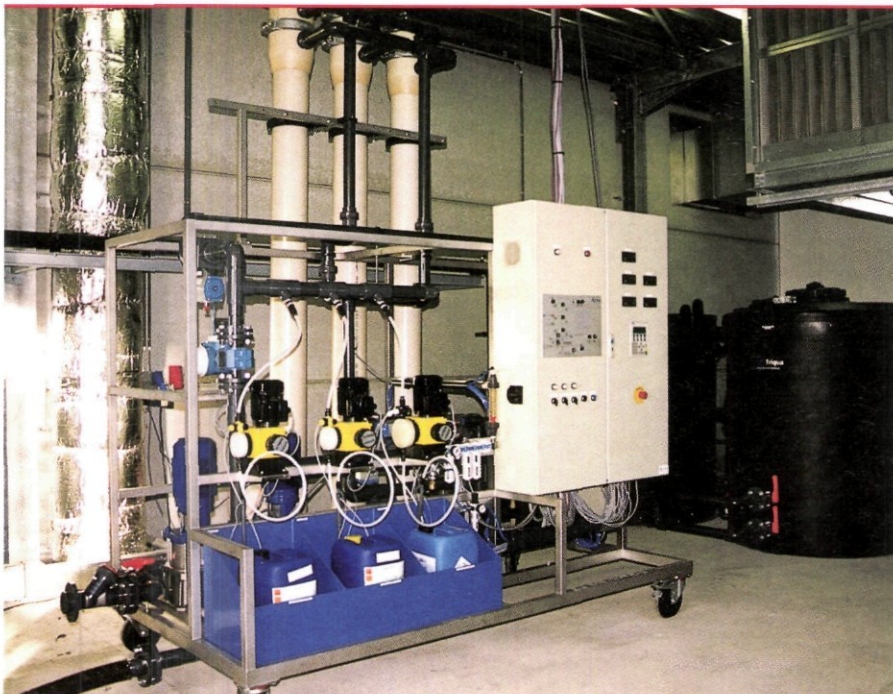
De hybride flow membraanfiltratie-installatie.
