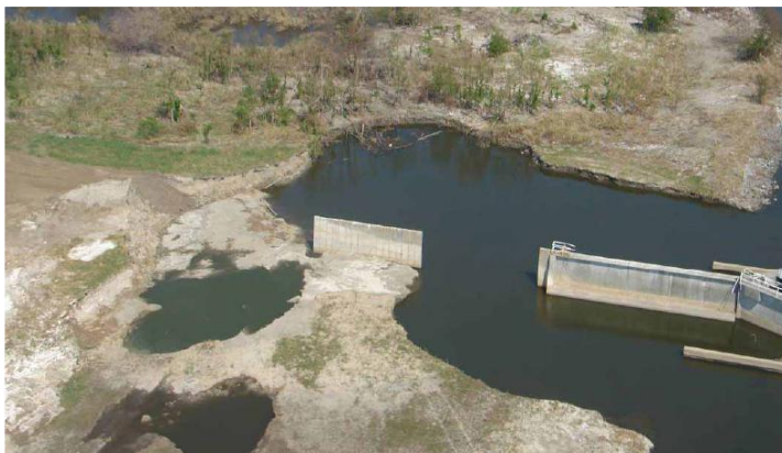
Figuur 1.2 Voorbeeld schade New Orleans na Katrina (2005), waarbij het kunstwerk nog redelijk ongeschonden is, maar de aansluitingen aan het onverstoorde dijklichaam geheel zijn weggespoeld. [Vrijling, J.K. en W. Kanning]
