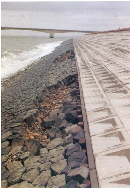
Figuur 1.1 Voorbeeld schade overgangsconstructie, basalt op gebroken puin op een vlijaag op klei: verdwenen basaltzuilen door onvoldoende klemming bij de overgang met haringmanblokken. Schade 1978, Oud Noord-Bevelandpolder nabij Zeelandbrug, Noord Beveland. [uit: Schadecatalogus voor dijkbekledingen, van der Meer, M.T. en M.R. Moens, ISBN 90-212-9501-6, 1990]
