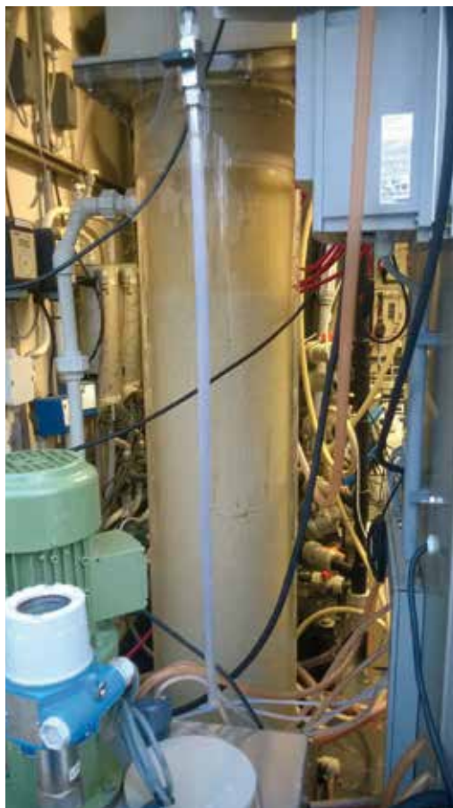
Korrelreactor van de PHA-proefinstallatie bij MAN Nederland (Foto: Paques)
