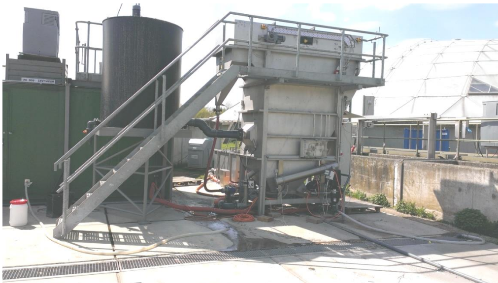
Afbeelding 2. DAF-installatie gebruikt in beide demonstratieonderzoeken
