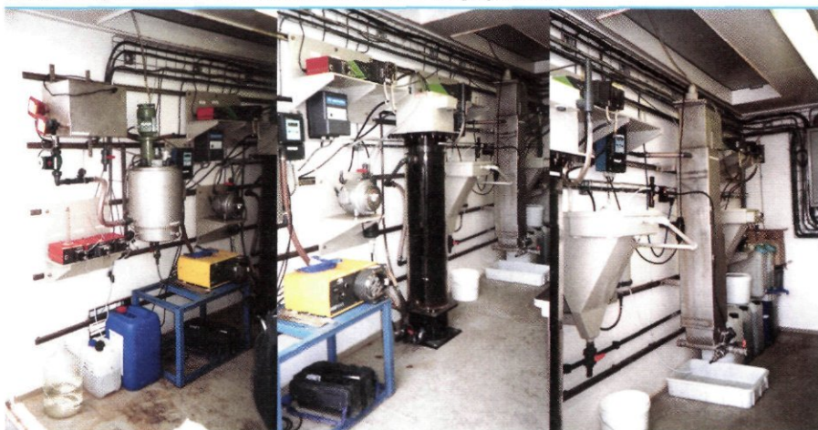
V.l.n.r. de mengtank, de anaërobe reactor en de aerobe reactor van de proefinstallatie.
