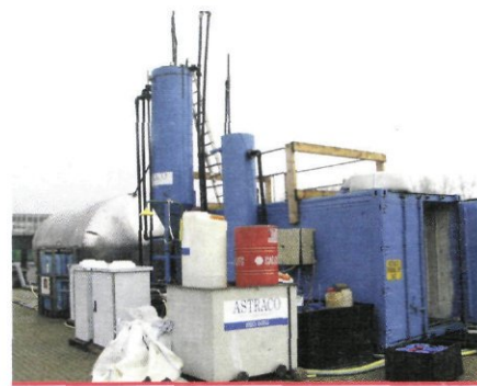
Filtratie van het effluent van een rioolwaterzuivering.
