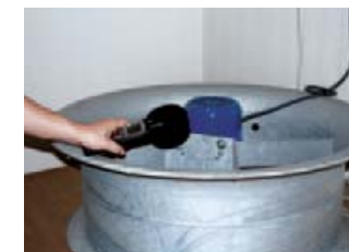
Luchtopbrengst Bovenaan staat dat de ventilator de juiste luchtopbrengst moet leveren.
