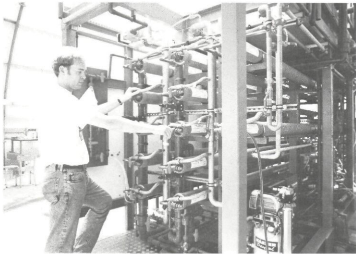
Afb. 3 - De proefinstallatie met nanofiltratie voor ontharding en kleurverwijdering op pompstation Hammerfliet van de NV Waterleiding Maatschappij Overijssel (foto WMO).
