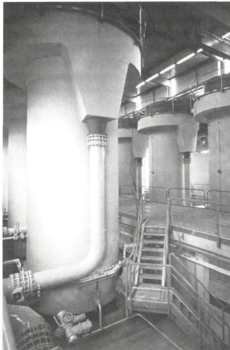
Afb. 2 - Korrelreactoren in de onthardingsinstallatie op drinkwaterproductiebedrijf Leiduin van Gemeentewaterleidingen Amsterdam.
