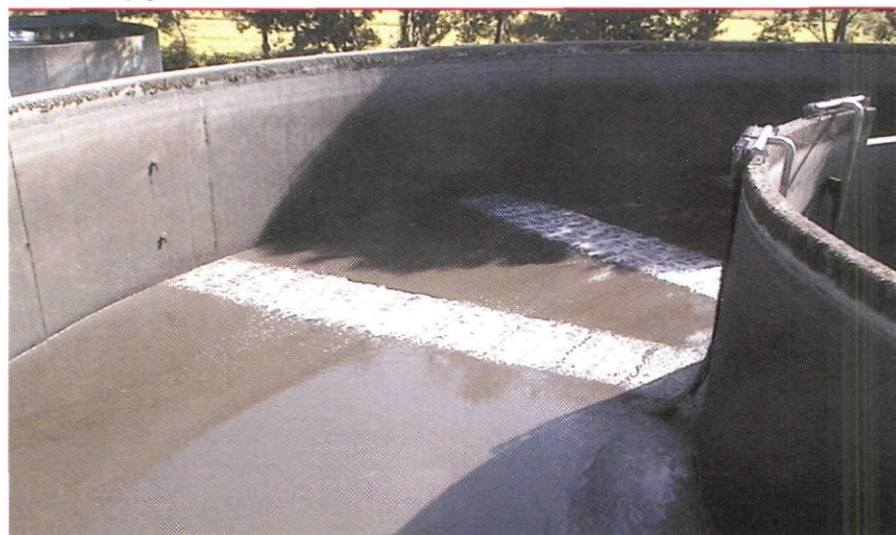
Plaatbeluchting op RWZI Sliedrecht.
