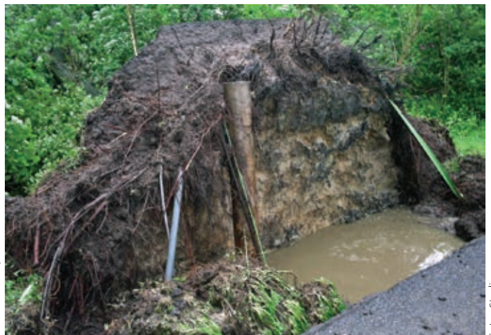
Gaslek en kabelbreuk door omgewaaide boom.
