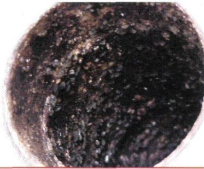
Monitoringspunt aan het begin van de pijp vóór dosering.
