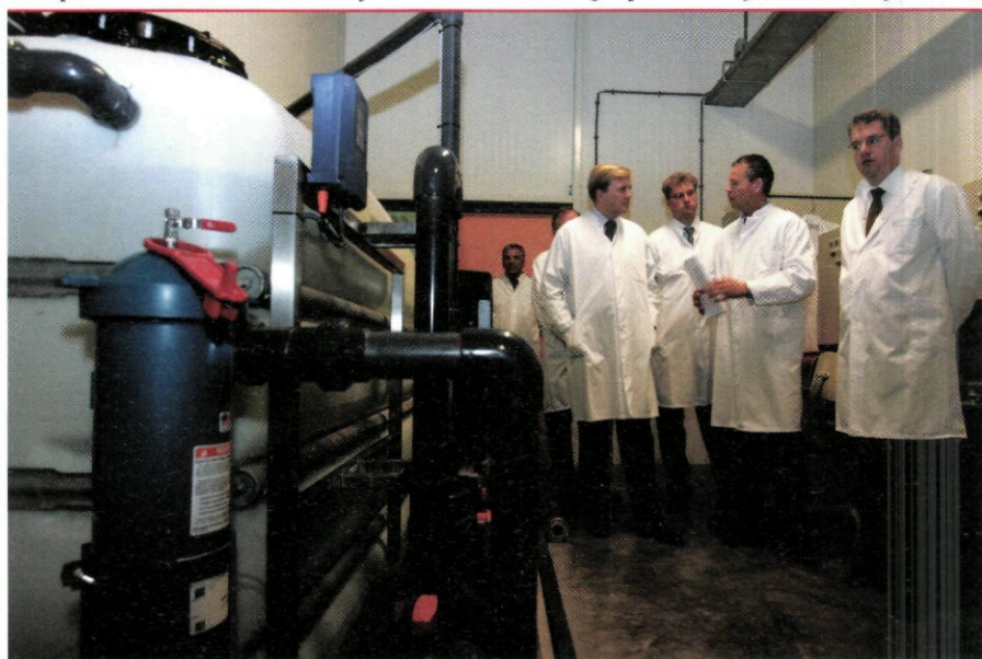
Kroonprins Willem-Alexander laat zich informeren over de waterkringloopinstallatie bij Rentex Floron (foto:FTN).
