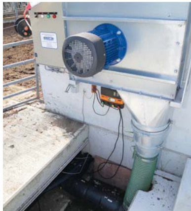
Deze installatie blaast vier keer daags een kwartiertje lucht door de houtsnipperbodem, zodat de bacteriën van het composteringsproces aan de gang blijven.
