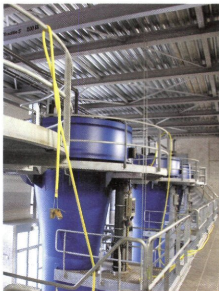
De onthardingsinstallatie van waterproductiebedrijf Nuland werd afgelopen november geopend.
