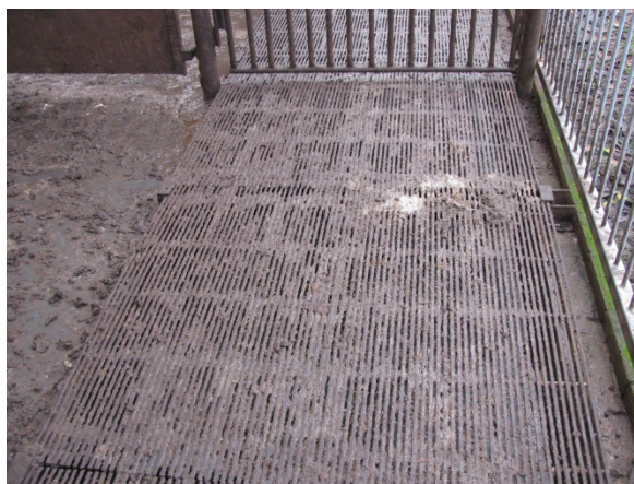
Driekantroosters boven de mestkelder achterin het hok buiten. Dit rooster is niet overkapt. Tegen de stal aan ligt een smal kanaal met betonnen roosters.
