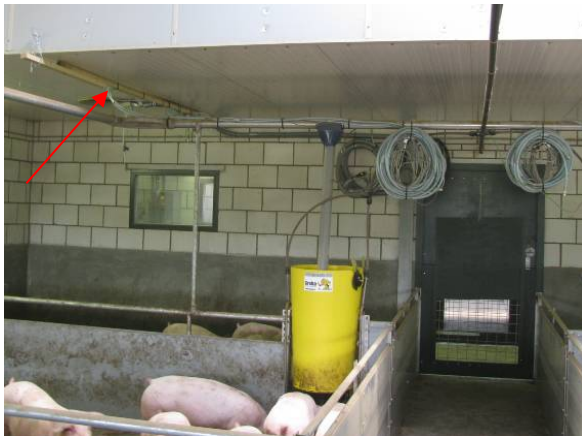
Luchtuitlaat (rode pijl)
