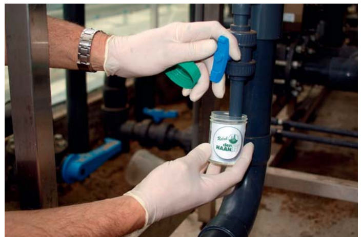
Door tweewekelijks het kiemgetal te bepalen van het water voor de ontsmetter en na de ontsmetter vermindert de werking van de ontsmetter niet ongemerkt
