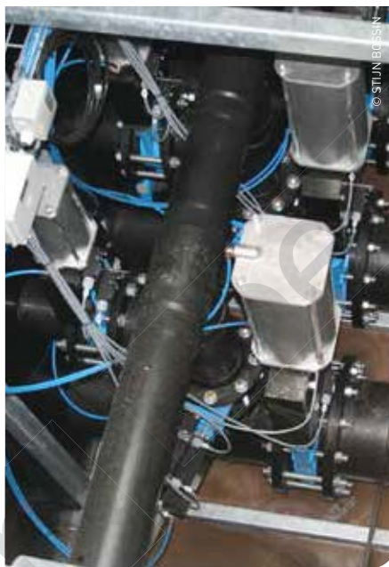
Het kleppensysteem om mest te verpompen bij installaties in de varkenshouderij.
