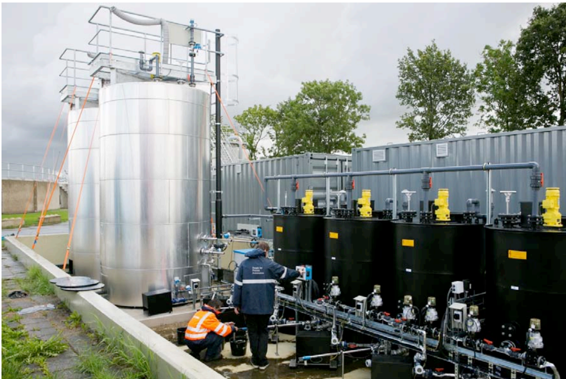
Afbeelding 8. De 20 m 3 -referentie en Ephyra ® -pilotinstallatie op de awzi Tollebeek
