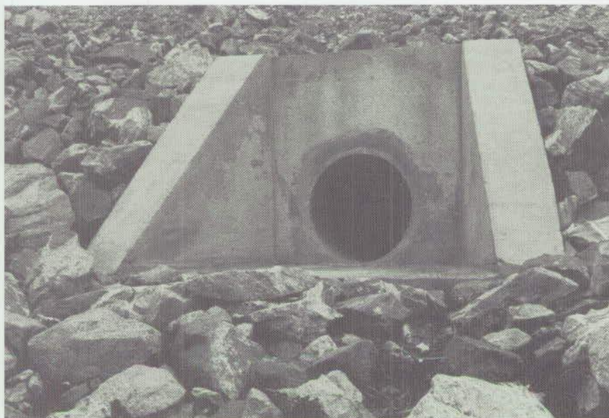
Ottertunnel op South Uist (Schotland)
