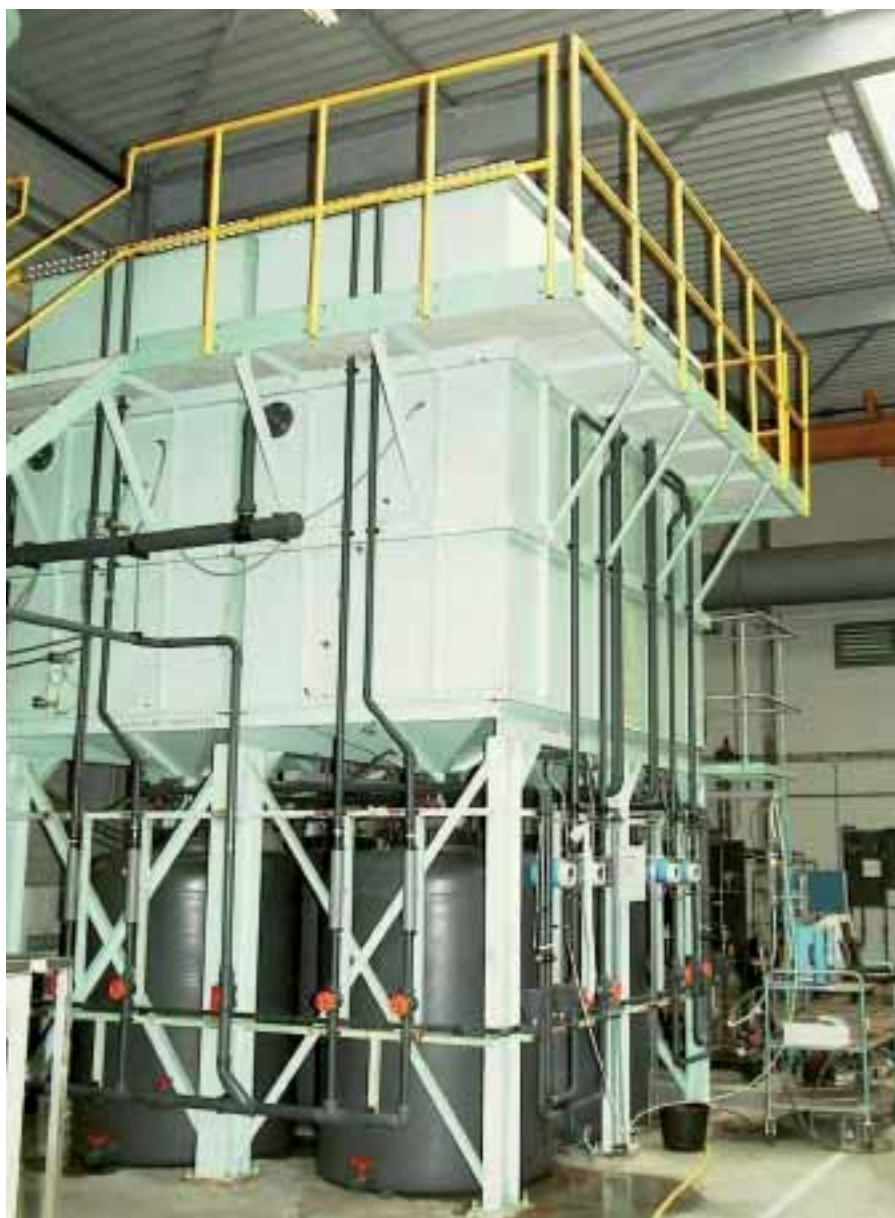
Proefinstallatie langzame zandfiltratie te Leiduin (Waternet)
