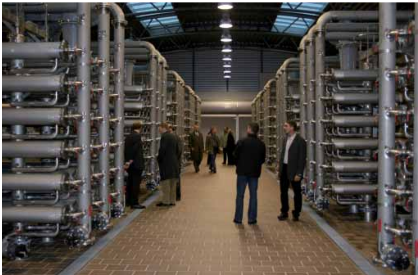
De ultrafiltratie-installatie in Roetgen
