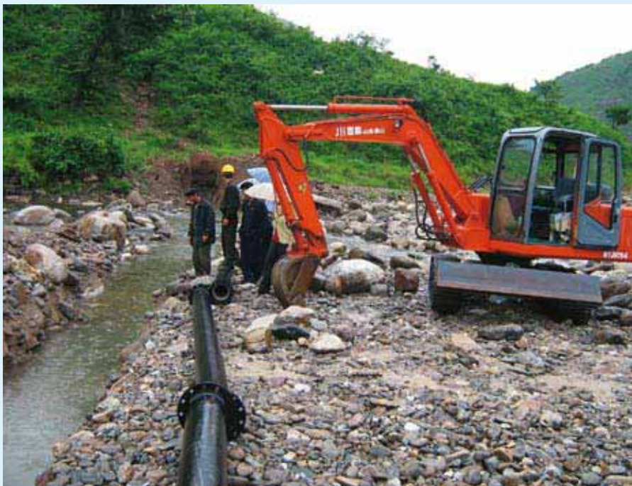
Vervanging van de pvc-buizen door stalen buizen en één van de rivierkruisingen, alsmede de voor het project aangekochte graafmachine.
