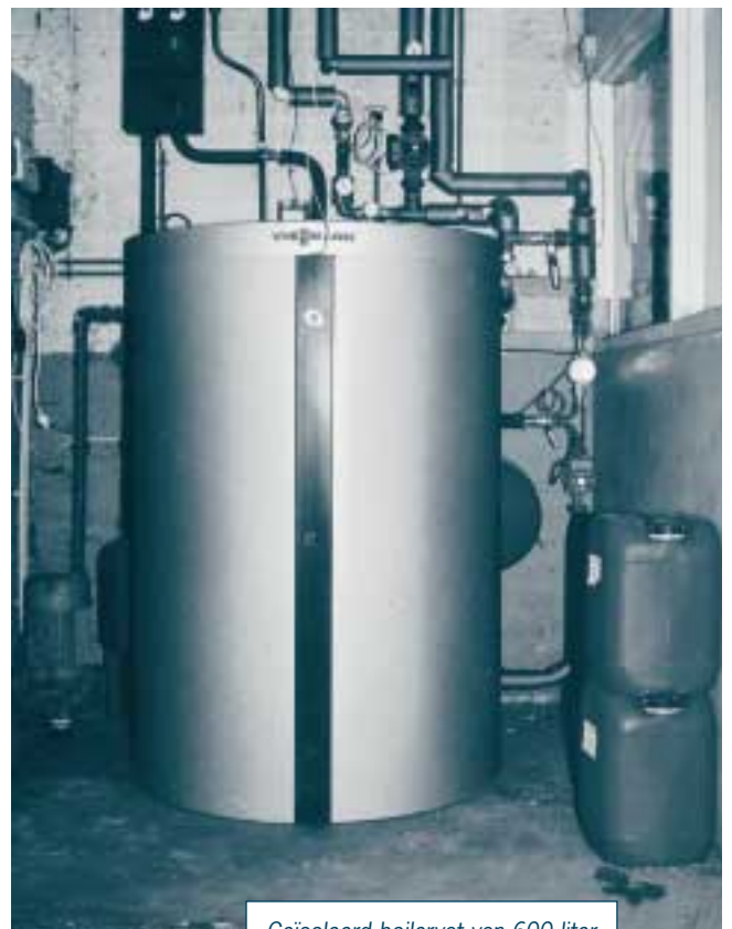
Geïsoleerd boilervat van 600 liter
