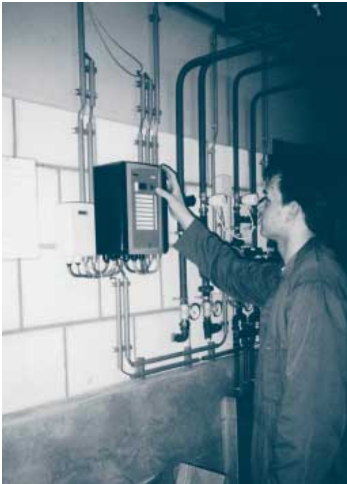
Zuinig omgaan met energie begint met een juiste instelling van de klimaatapparatuur
