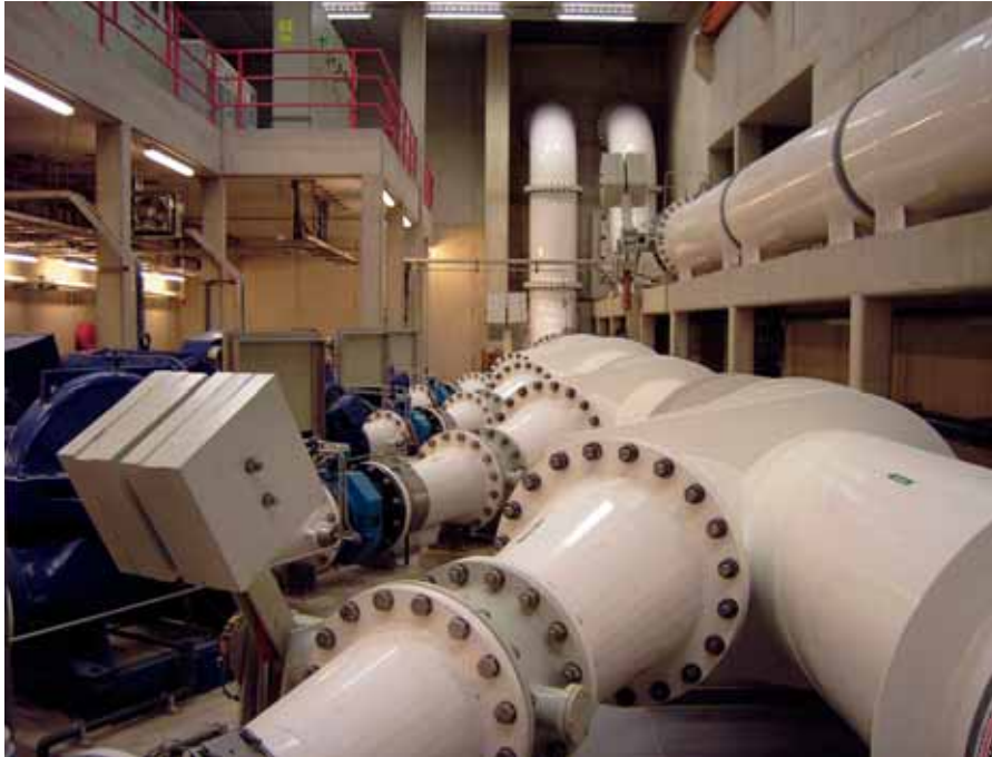
Eén van de hogedruk pompstations in Oelegem.
