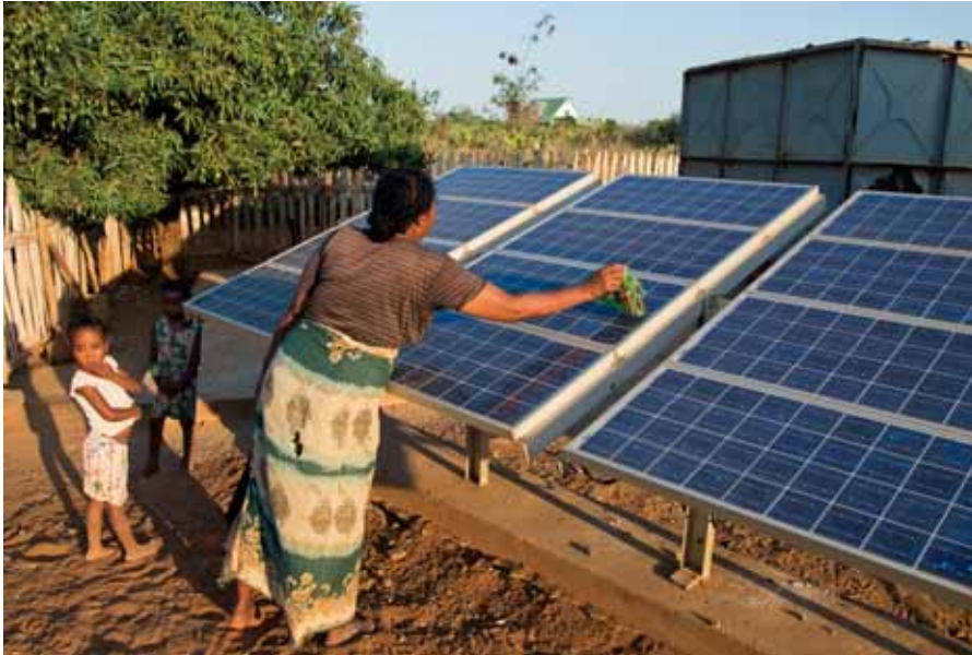
Zonnepanelen die de waterpomp van energie voorzien.
