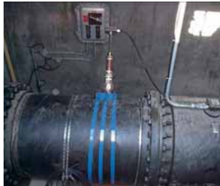
Een opstelling met de nieuwe flowmeter.
