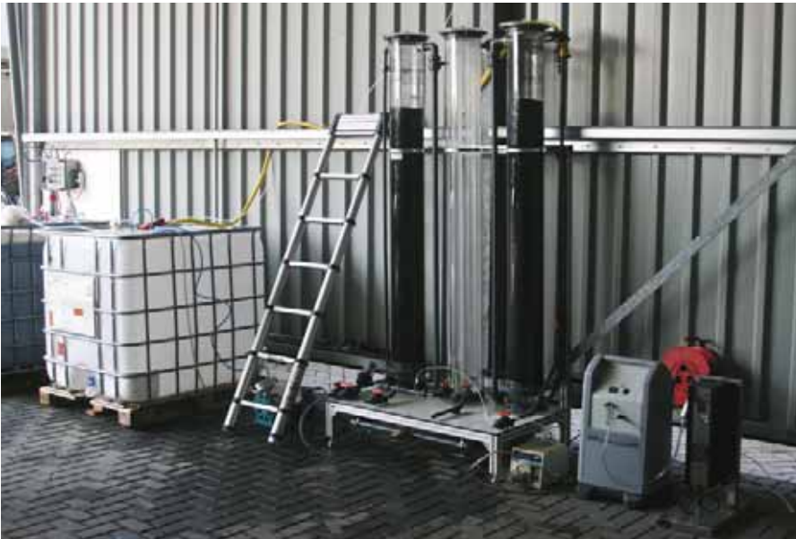
De installatie bestaat uit twee koolfilters en een ozongenerator.
