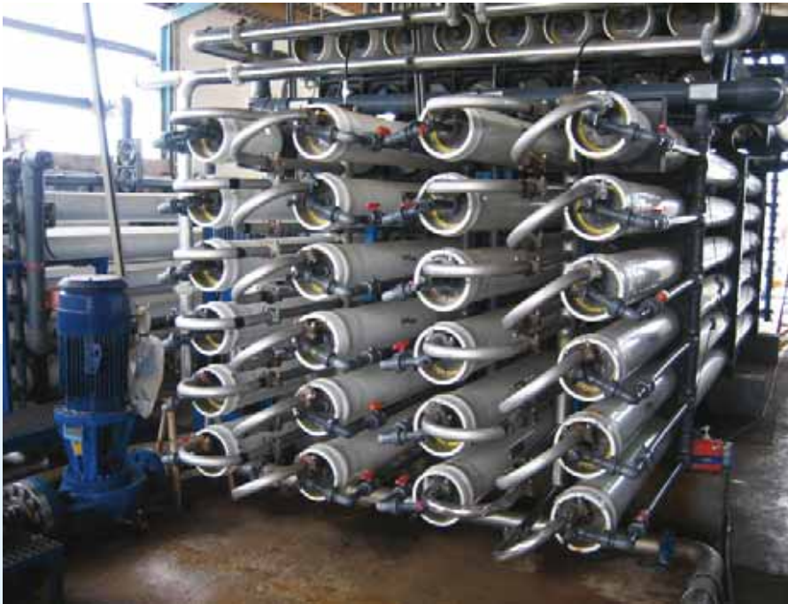
De RO-installatie op Bonaire.
