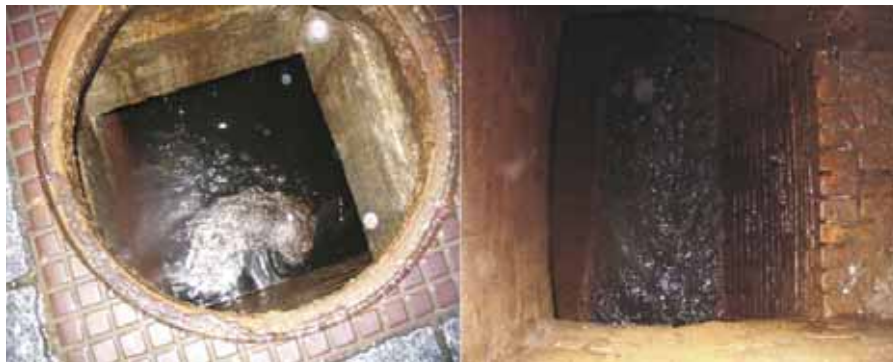
Overstortput in de Houtstraat (links) en de benedenstroomse overstortleiding aan dezelfde straat op ongeveer dezelfde tijd: 14.54 en 14.59 uur (rechts).
