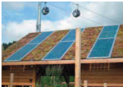
77. Op de Floriade 2012 werd de combinatie van een groen dak met zonnepanelen getoond.
