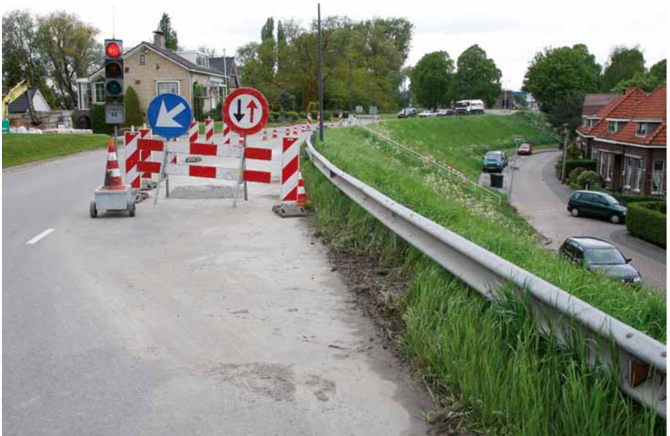
Scheur in Lekdijk bij Krimpen aan de IJssel door gietijzeren leiding (foto: Martin Droog).
