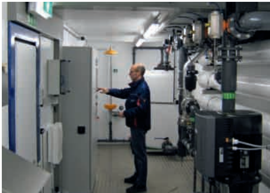
De proefinstallatie in Zevenbergen.
