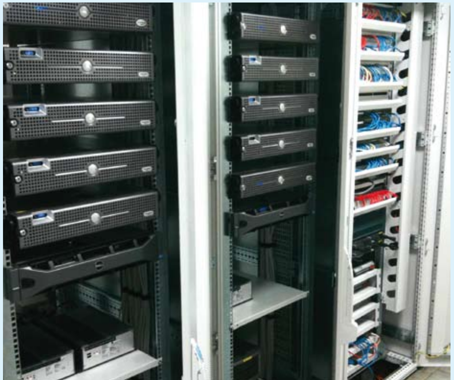
Eén van de serverruimtes van Vitens.
