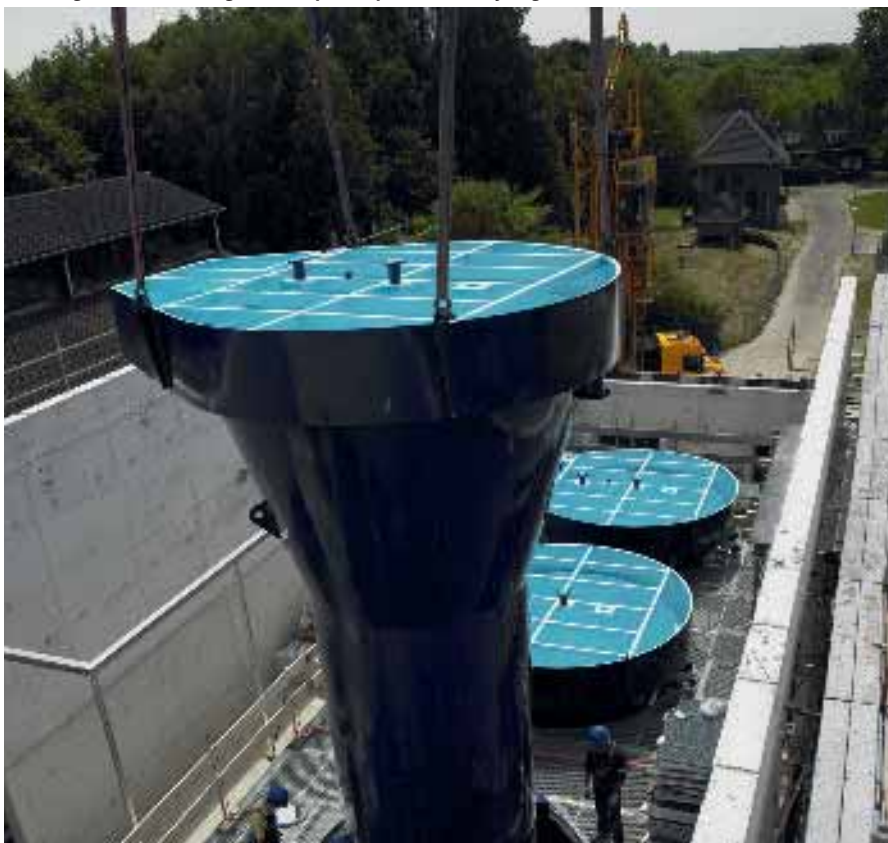
Plaatsing van de onthardingsreactor op waterproductiebedrijf Veghel.
