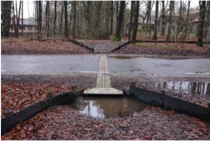
Door hevige regenval kunnen paddentunnels, gelegen in een aflopende helling, tijdens de paddentrek onder water komen te staan en daarmee hun functie 'tijdelijk' verliezen.
