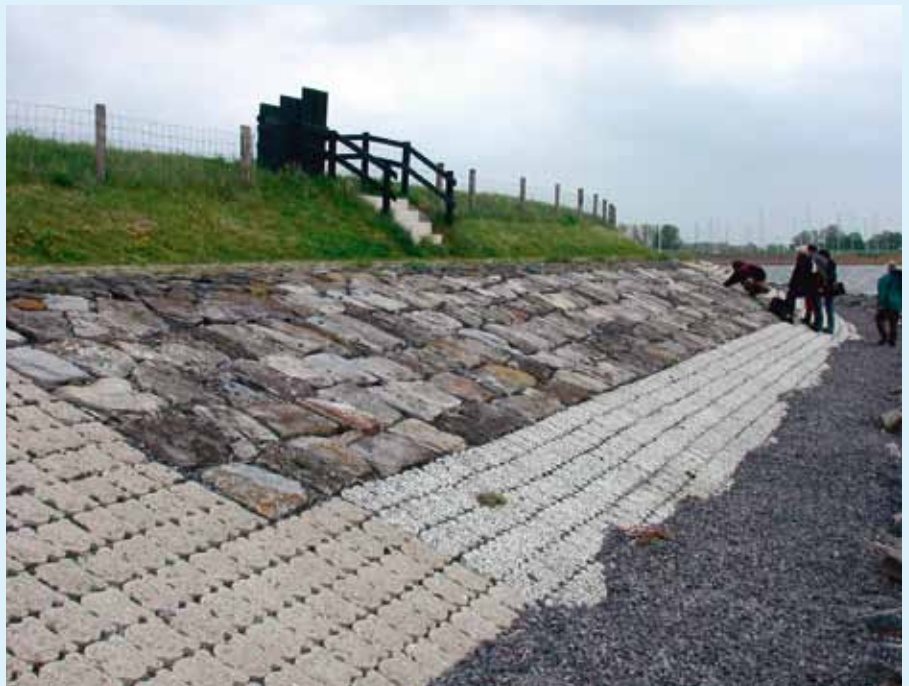
Dijkvak met hergebruikte basalt en kalksteen omringd door beton op de Westerlanderdijk bij Wieringen.
