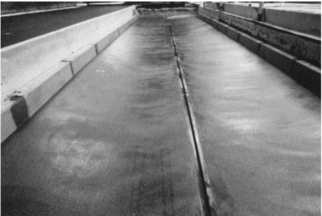
Een hellende dichte vloer met giergoot geeft een lagere ammoniakemissie.
